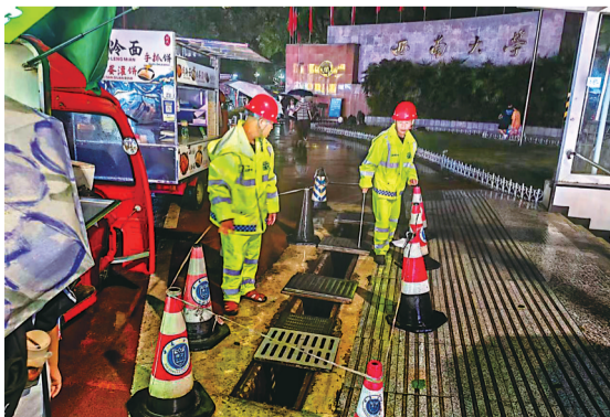
北碚區排水工人在西南大學門口揭開窰井蓋防澇
